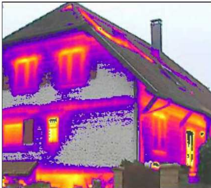
Les couleurs « chaudes » traduisent les déperditions de chaleur. Document société DER
